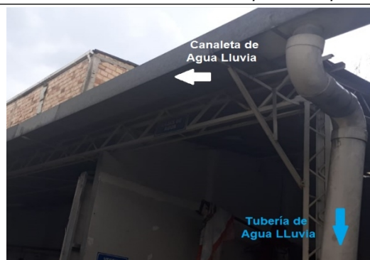
Foto No. 6. Sistema de Agua Lluvia
